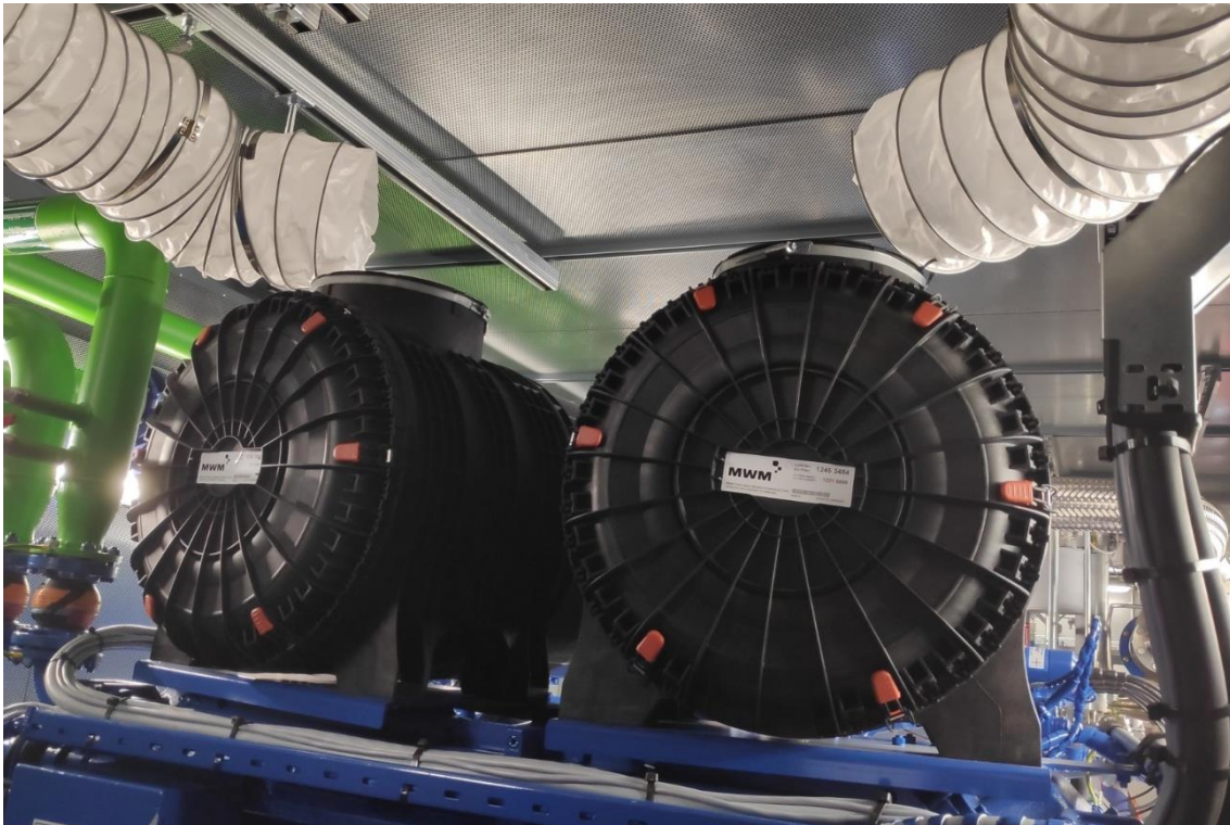
Abb. 3: Zuführstelle der Gärrestabluft direkt über den Luftfiltern eines der beiden BHKW-Module
